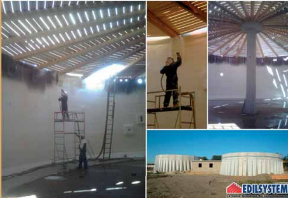
Depuratore loc. Nepi - (RM)
