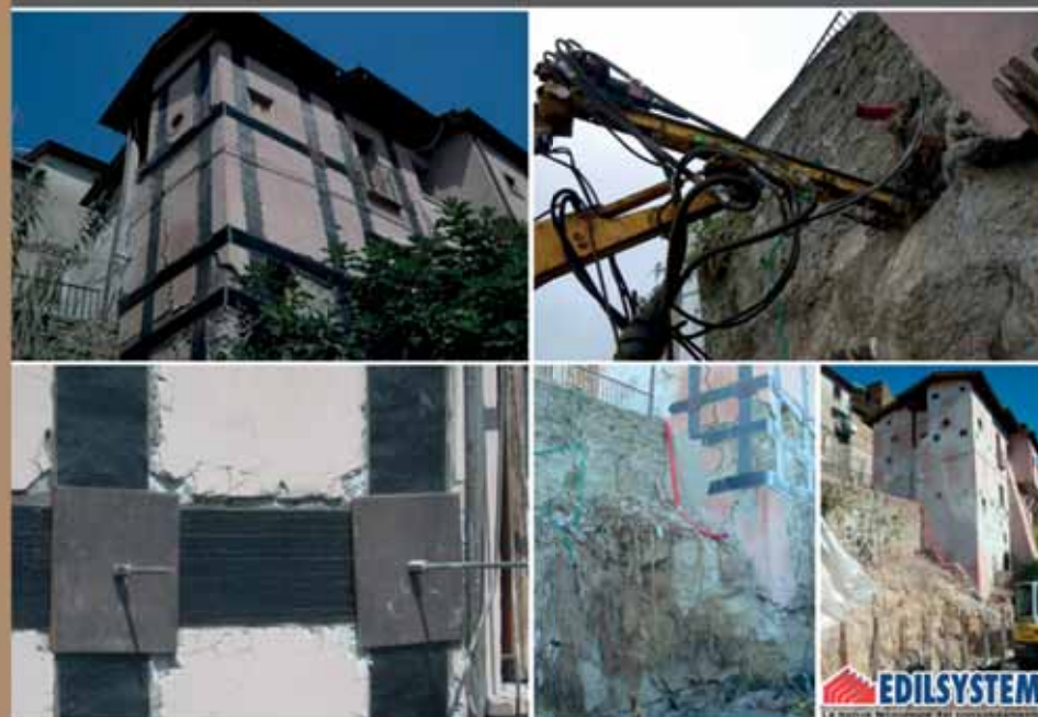
Comune di Roma - Edificio pericolante - Cesano
